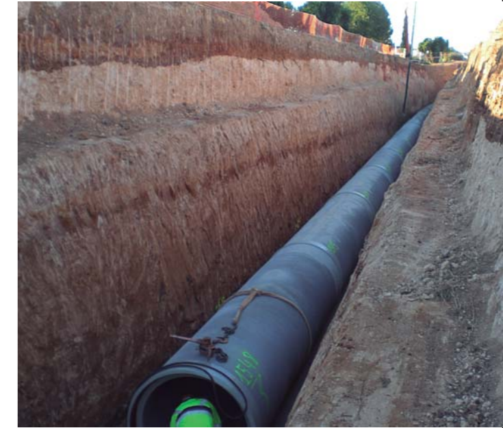
● Conducción para reutilización de aguas residuales de Catarroja - Benifaió (Valencia). ● Pipes for the recycling of the sewage water of Catarroja - Benifaió (Valencia).
